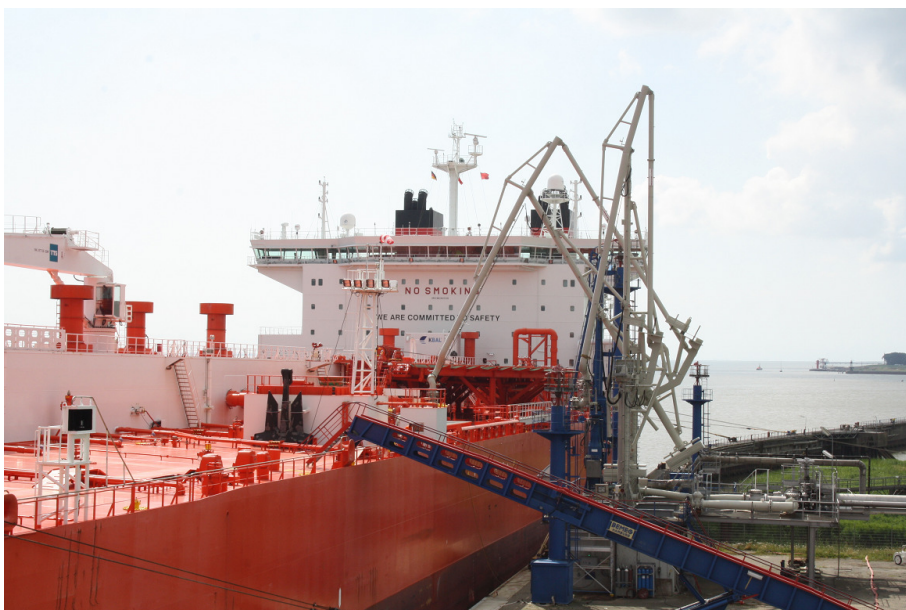
Die neuen Öl-Löscharme im Elbehafen Brunsbüttel
